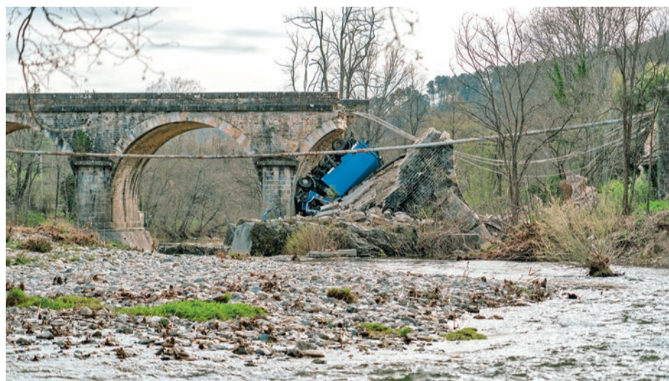
Le 18 mars, une partie du pont de Chamborigaud s'est effondrée, mais n'a miraculeusement pas fait de victime.
