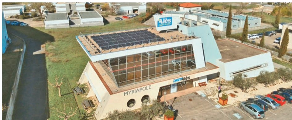
Le bâtiment Myriapole, dédié au développement numérique, ne cesse de se réinventer. Son nouveau système d'autoconsommation électrique a été inauguré le 14 mars.
