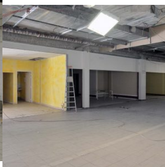
Le projet de modernisation nécessite le démontage complet de la médiathèque et d'une partie de la galerie du Centre Alès.
